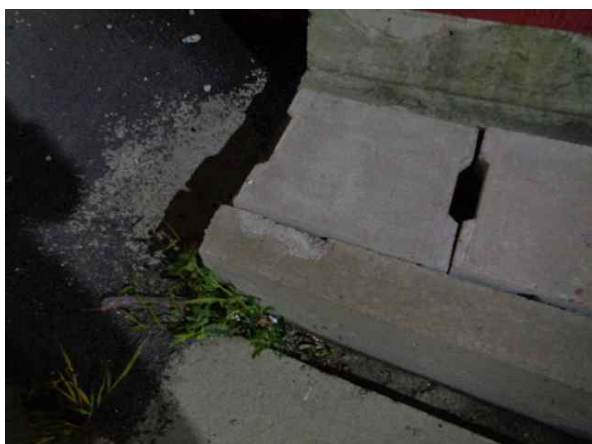
공동구 S12 파손-문산방향
