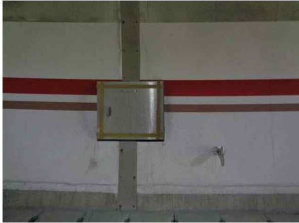
라이닝 S19 측벽부 균열( C_w=0.3\text{mm} 미만)-문산방향
