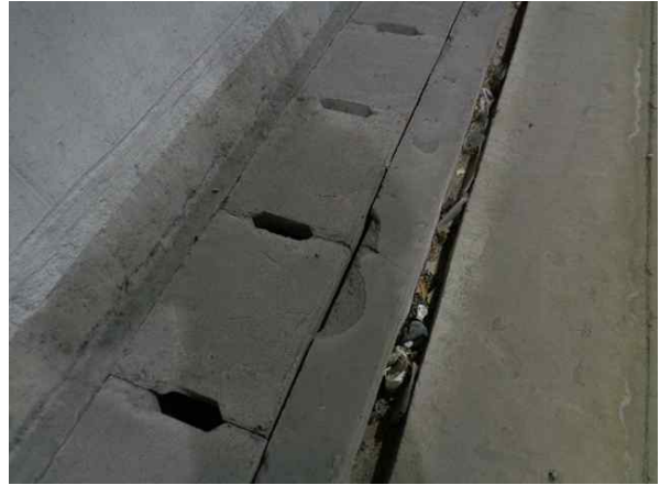
공동구 S21 파손-서울방향
