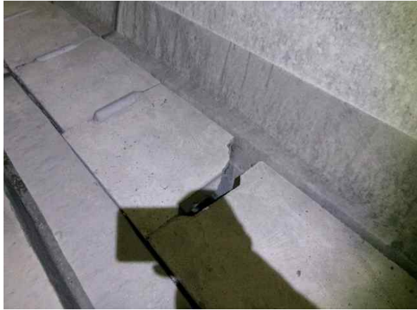
공동구 S40 덮개 파손-문산방향
