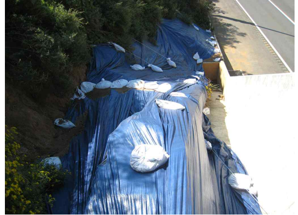
시점측 갭문 측면 토사유실 임시보수-문산방향
