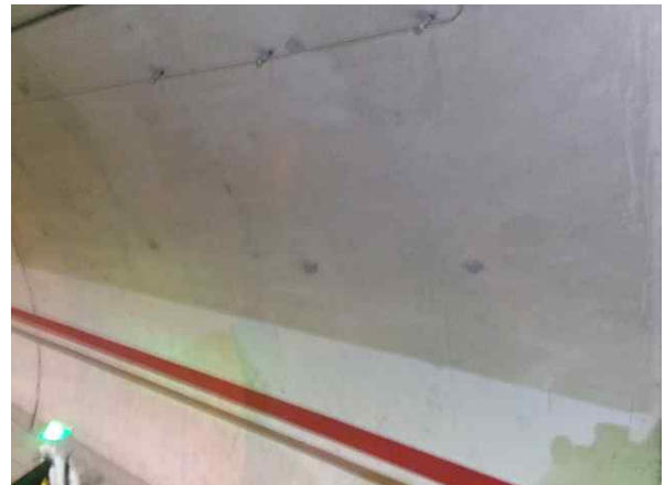
라이닝 S28 천단부 망상균열-서울방향
