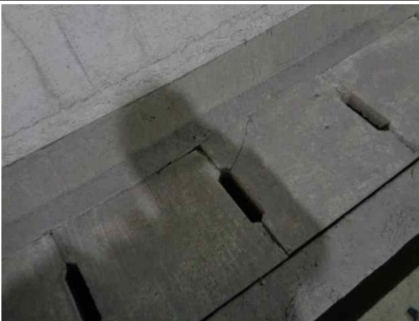
공동구 S07 덮개파손-서울방향
