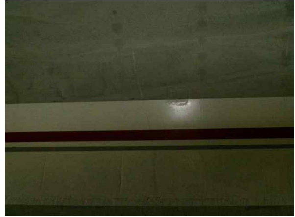
라이닝 S29 측벽부 균열( C_w=0.3\text{mm} 이상)-서울방향
