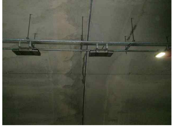
라이닝 S20 천단부 조인트부 들뜸-문산방향
