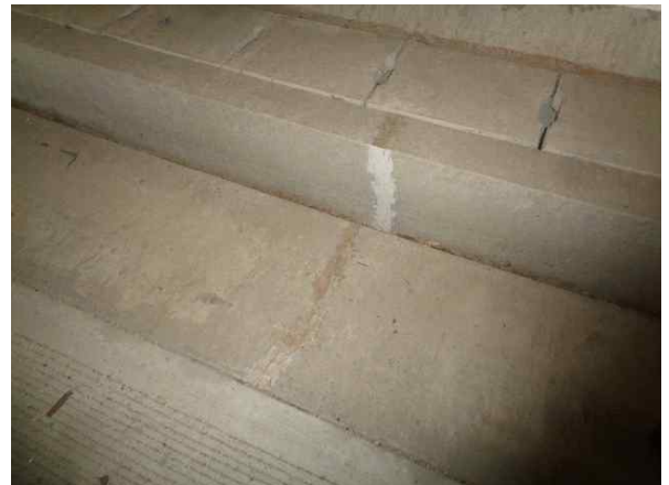
공동구 S08 균열 보수완료-문산방향
