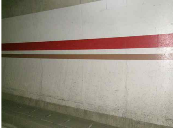
라이닝 S27 천단부 균열( Cw=0.3\text{mm} 미만)-서울방향
