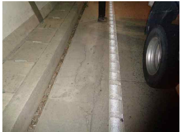
포장부 S35 갓길측 파손-서울방향
