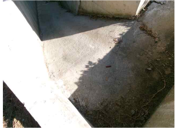
중점측 갭문 배수로 균열(Cw=0.3mm이상)-서울방향
