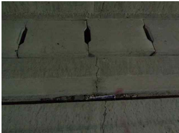
공동구 S20 균열( Cw=0.3\text{mm} 이상)-서울방향
