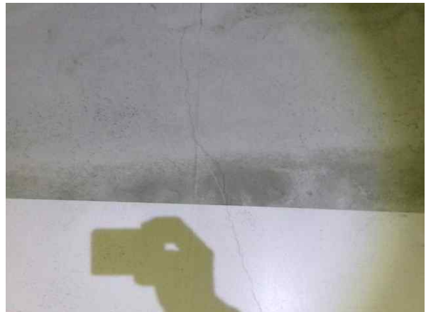
라이닝 S16 측벽부 균열( Cw=0.3mm 이상)-문산방향
