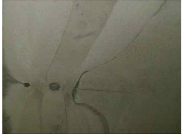
라이닝 S05 천단부 균열( Cw=0.3\text{mm} 이상)-서울방향
