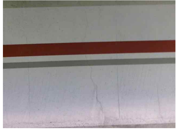
라이닝 S09 측벽부 균열( C_w=0.3\text{mm} 이상)-서울방향
