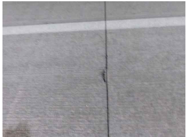
포장부 S04 파손-문산방향
