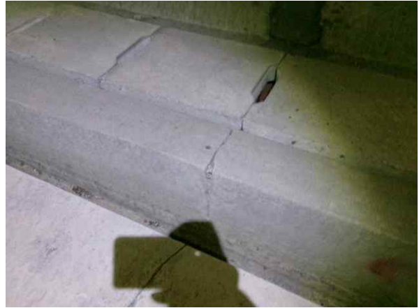
공동구 S08 균열(Cw=0.3mm미만)-문산방향
