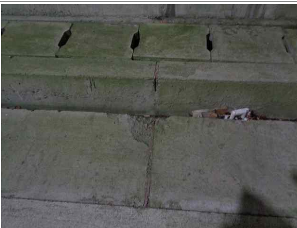
포장부 S43 갯길측 파손-서울방향
