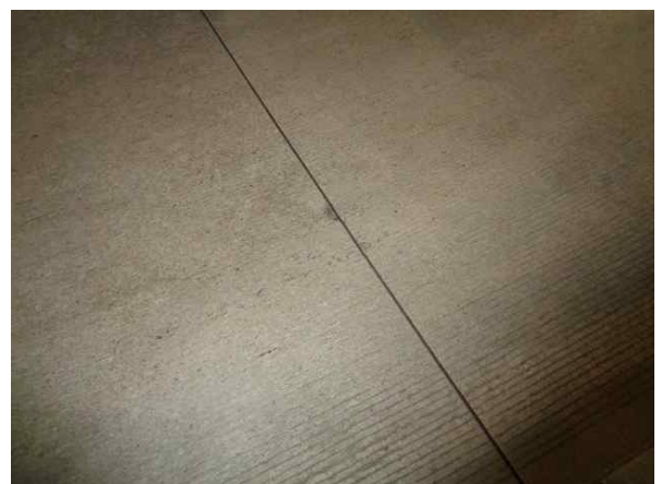
포장부 S39 포장부 파손-문산방향
