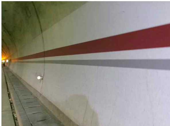
라이닝 S13 측벽부 망상균열-문산방향
