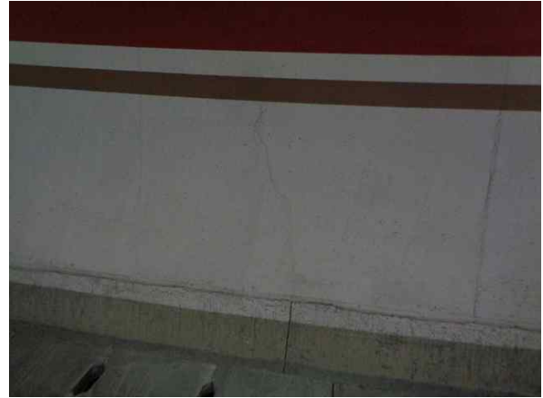
라이닝 S22 측벽부 균열( C_w=0.3\text{mm} 미만)-문산방향
