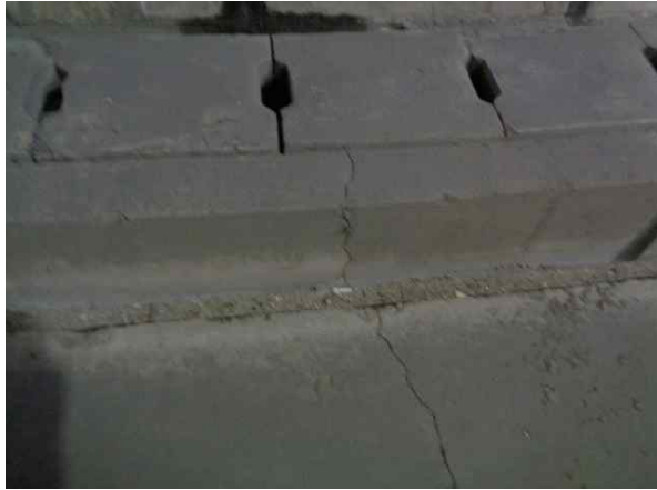
공동구 S20 균열(Cw=0.3mm이상)-서울방향
