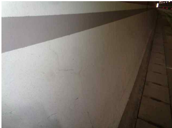
라이닝 S21 측벽부 망상균열-서울방향
