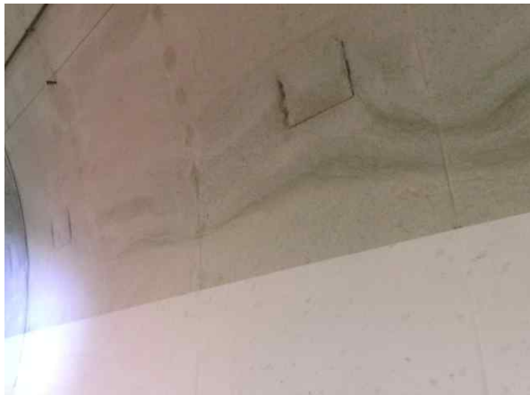
라이닝 S28 측벽부 균열( C_w=0.3\text{mm} 미만)-서울방향
