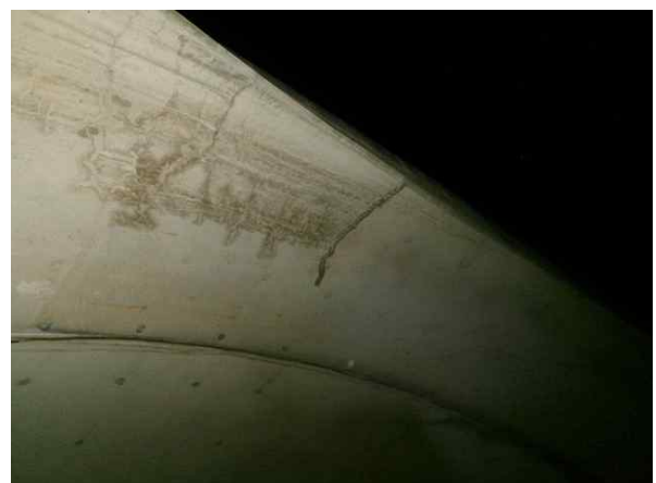
라이닝 S01 천단부 균열부백태-서울방향
