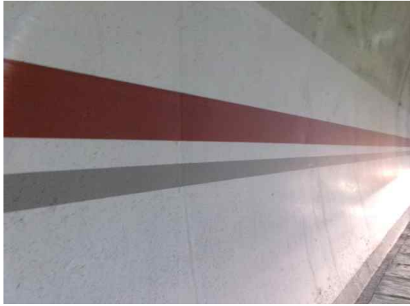
라이닝 S03 측벽부 망상균열-서울방향
