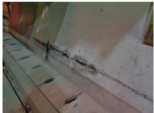
라이닝 S36 측벽부 하단 누수흔적-문산방향
