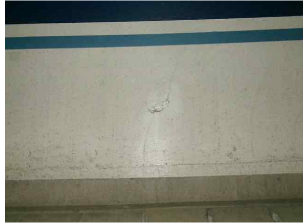
라이닝 S40 측벽부 균열( C_w=0.3\text{mm} 미만)-서울방향
