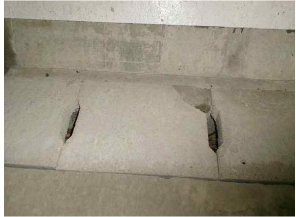
공동구 S44 뒹개파손-서울방향
