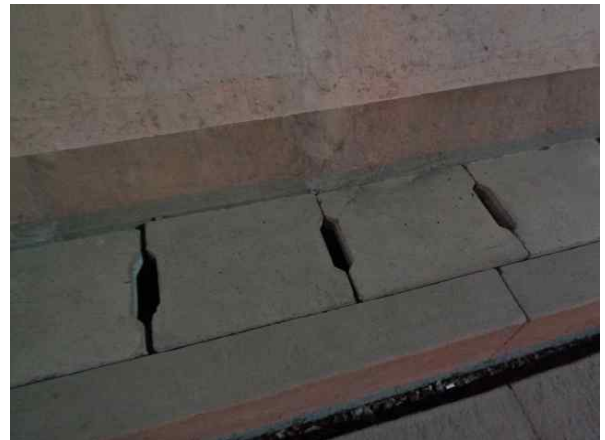
공동구 S39 뒹개 파손-서울방향
