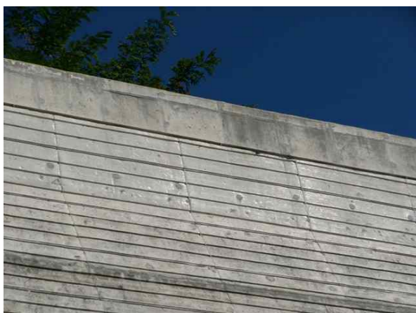
시점측 갭문 균열( C_w=0.3\text{mm} 미만)-서울방향
