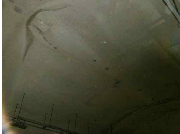
라이닝 S09 천단부 균열( Cw=0.3\text{mm} 이상)-서울방향
